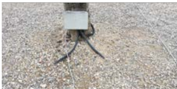
야외에 설치되는 콘센트의 잘못된 예(낮은 위치)
