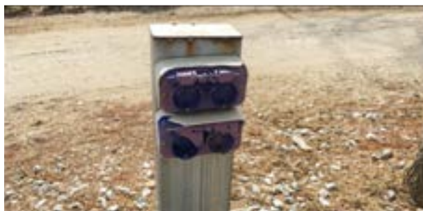
단자함 설치의 좋은 예(방수형함, 설치 높이, 위험 표시)
