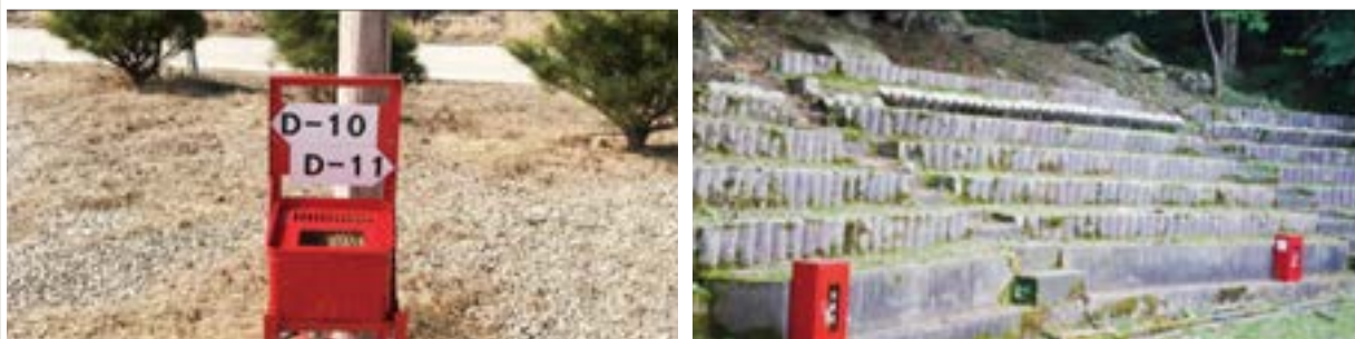
소화기 설치의 좋은 예(배치거리)
