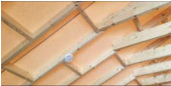
바닥의 기초와 기둥을 갖추고 지면에 고정된 야영시설(글램핑텐트) 내 연기감지기 설치의 좋은 예
