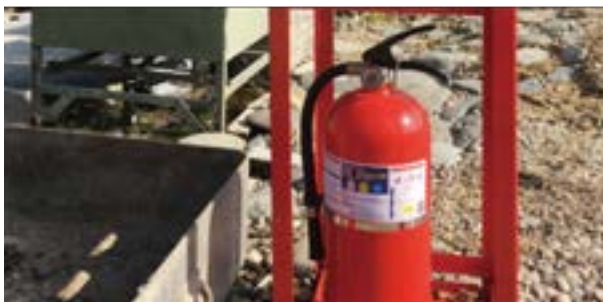
숯 및 잔불처리 시설 설치의 좋은 예 (재수거함 옆 소화기 비치)
