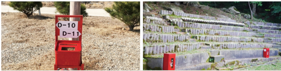
소화기 설치의 좋은 예(배치거리)
