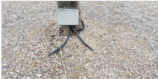
야외에 설치되는 콘센트의 잘못된 예(낮은 위치)
