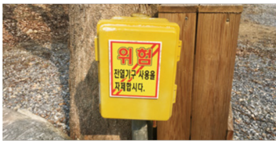
단자함 설치의 좋은 예(방수형함, 설치 높이, 위험 표시)
